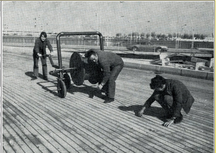
1968 Installazione del nastro scaldante su una rampa di accesso a una piattaforma di parcheggio per autobus, all'aeroporto di Orly, vicino a Parigi (Electric heating of the roadways, by Robert Félix, 1971, Ultimheat Museum*)
